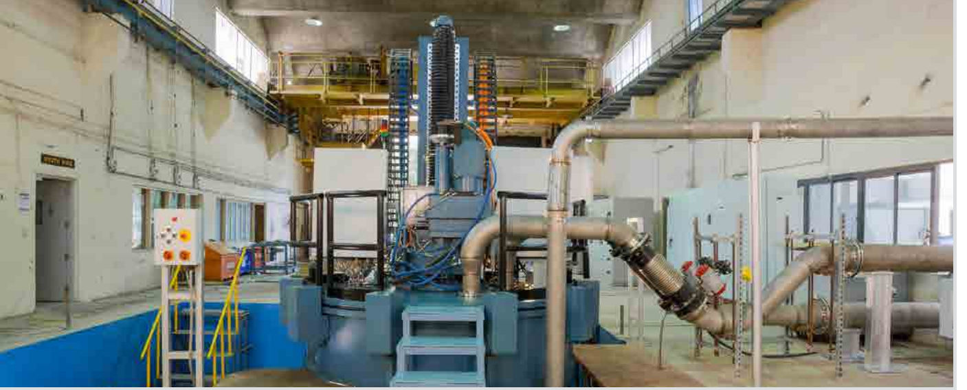
एयूएससी मिशन परियोजना के लिए उन्नत सामग्री के परीक्षण हेतु स्थापित युनिक हाइ टेम्परेचर स्पिन टेस्ट रिग (एचटीएसटीआर)
